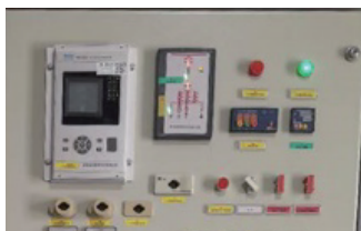
开关柜安装效果图
