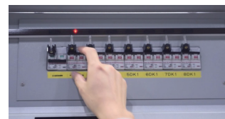
倒闸操作：二次操作
