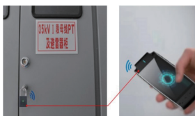
倒闸操作：一次操作
